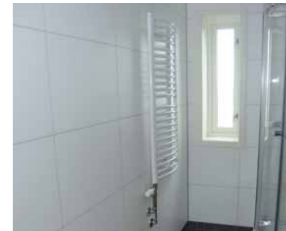
VARMER: Håndklettørkere med vannbåren varme kan også varme badet, i tillegg til el-kabler i gulvet.
